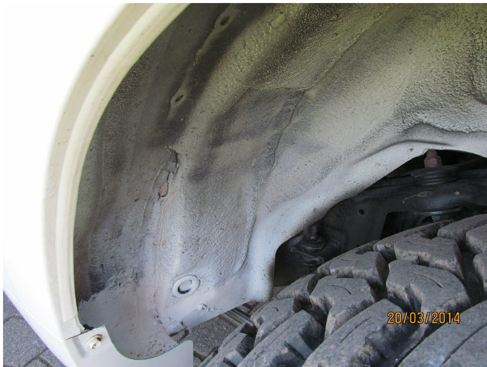
Bild 14: lackierter Schweller / Radhaus links
